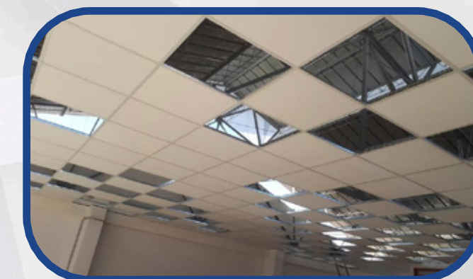
Falso cielo raso (Baldosas)
